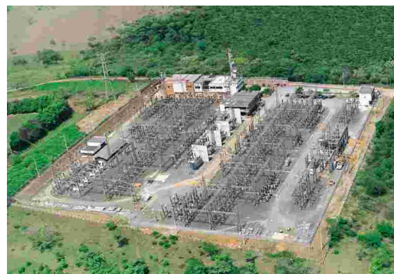
Subestación Pance en Cali
